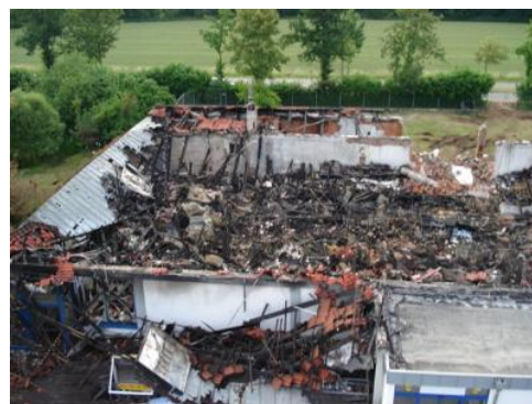
Brand Lidl Markt Höchst am 25.6.2006 – Totalverlust innerhalb von 30 Minuten. Bilder: FFW Höchst
