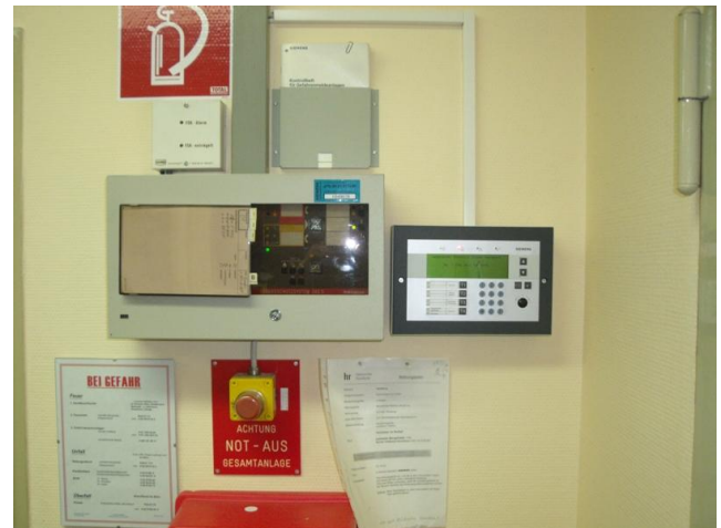
Die Brandmeldezentrale im Sendergebäude
